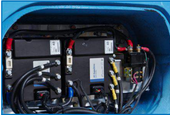
Die DANAHER AC-Controller sind im Heck angebracht und über ein CAN-BUS-System verbunden.
